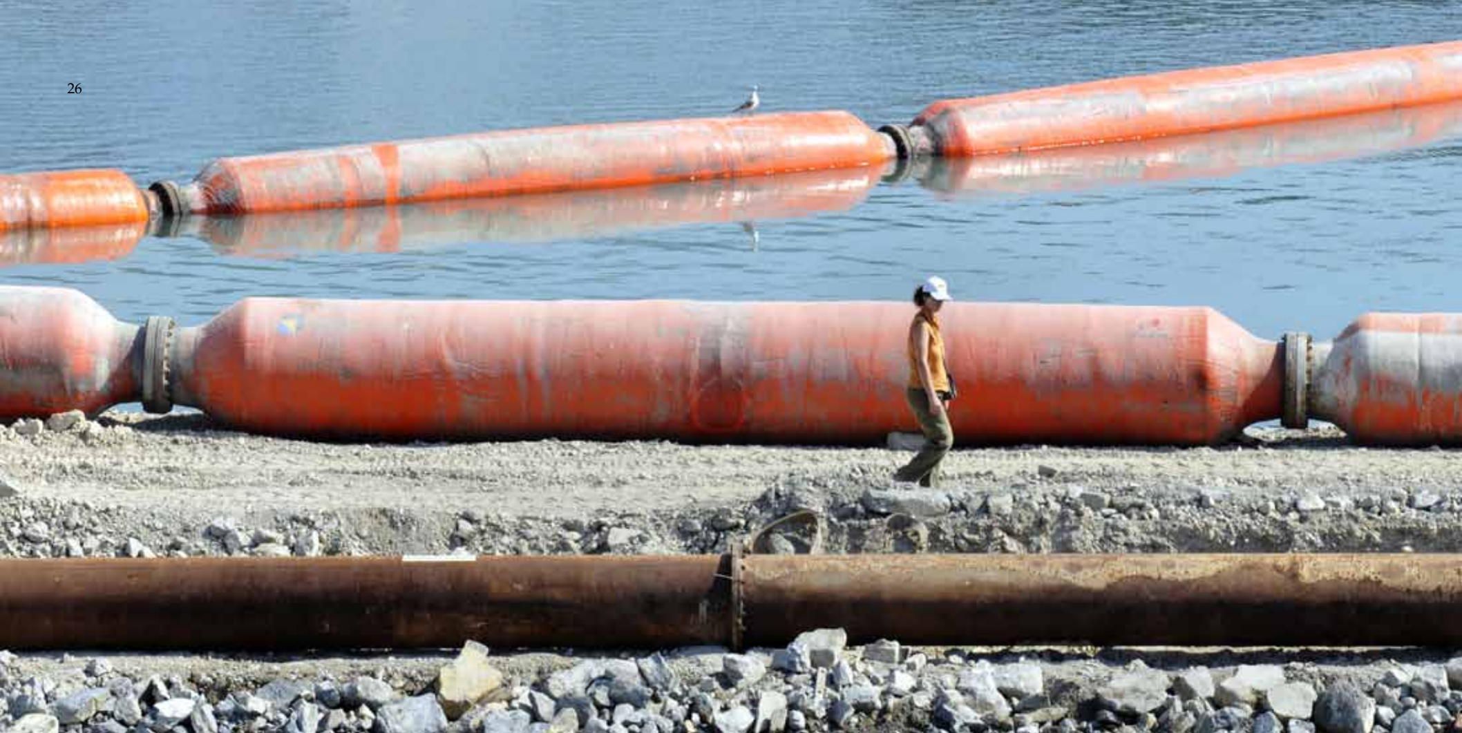
Condotte trasporto materiali dragati | canalisations d'évacuation des matériaux de dragage
